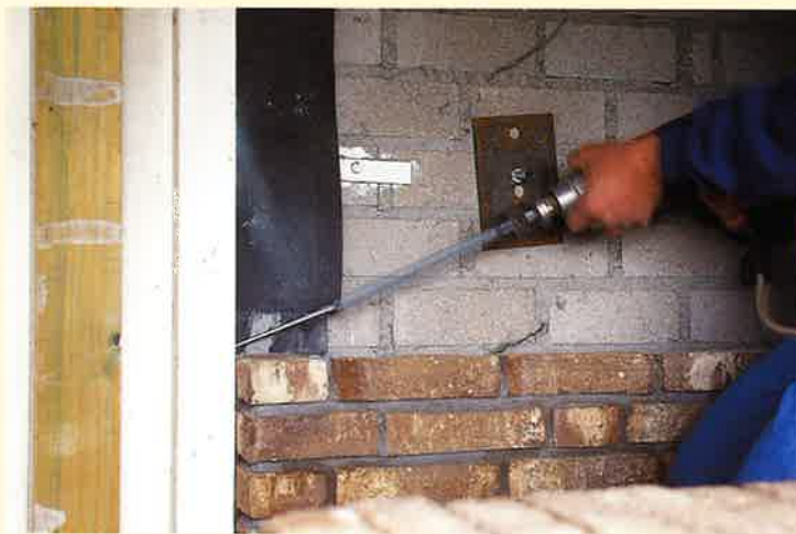
Extra kozijnanker in buitenspouwblad is onnodig en veroorzaakt scheuren
